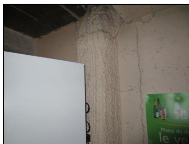
Photo N° 938 AMIANTE CIMENT -- LOCAL VO -1 Gaines & coffres verticaux Ventilation haute (Fibres- ciment)
