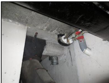
Photo N° 940 AMIANTE CIMENT -- LOCAL VO -1 Gaines & coffres horizontaux Coude de ventilation haute (Fibres-ciment)
